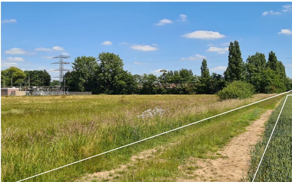
Onderstation van Liander; gelegen naast het pad langs en naar het plangebied
